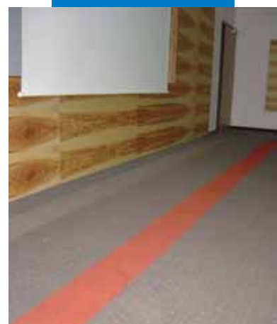
Παράδειγμα εφαρμογής Primer G πριν την εφαρμογή του Ultraplano Eco και της κόλλας Rollcoll , που χρησιμοποιήθηκε για τη συγκόλληση χαλιού σε ένα δωμάτιο ξενοδοχείου - Ξενοδοχείο Villa Castellani - Αυστρία
